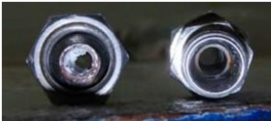
Состояние трубок без Гидрофлоу (слева) и с Гидрофлоу (справа). С Гидрофлоу отложений нет.
