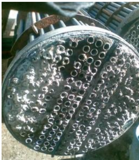
накись в теплообменнике нефтеперерабатывающего завода
